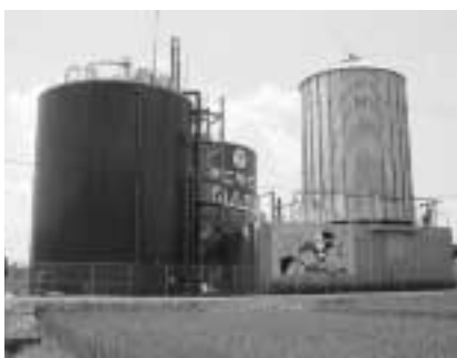
消化槽ガスホルダー
