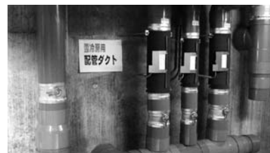
ダクトを通じて冷気を屋内に循環
